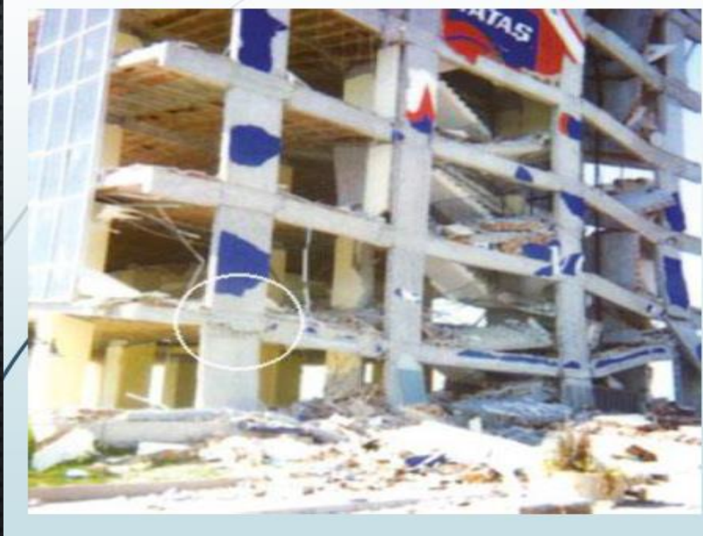
Zemin Kat Perdede Çatlak Örneği
