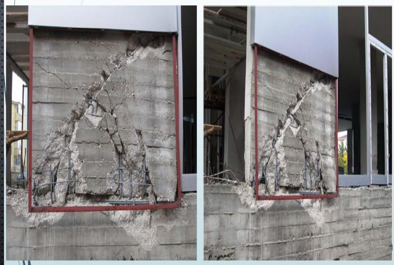
Perdede Çatlak Örneği – Van Depremi Sonrası
